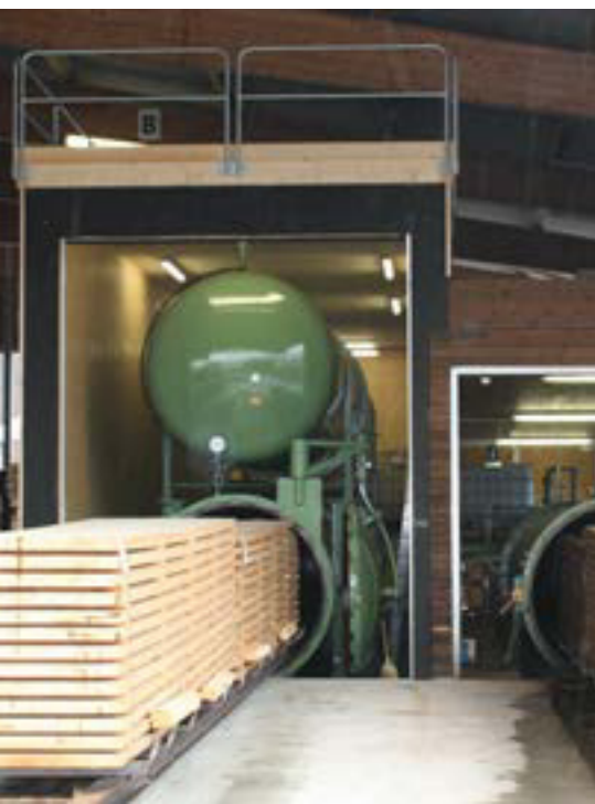
Die Kesseldruck-Imprägnieranlage steht seit 2015 in einer Produktionshalle aus Schweizer Holz.
